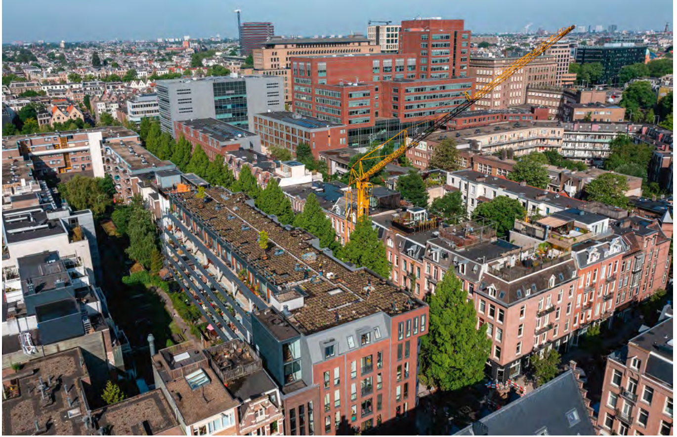
Groene daken koelen de stad. Hier de aanleg van een groen dak in de Tilanusstraat Amsterdam (Foto René Post & The Urban Jungle Project. Zie ook pag. 13)
