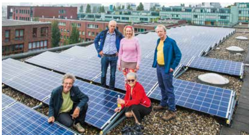
Leden van het collectief Zon op Zeeburg in 2017 op het dak van Entrepotbrug. Zij realiseerden toen hun eerste zonnestroomproject voor bewoners, waaronder veel sociale huurders. Op de Entrepotbrug namen 44 bewoners 250 zonnepanelen af.
